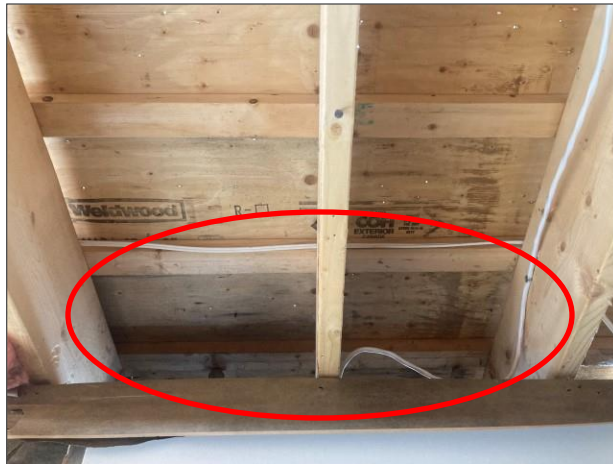
Photo 3 – Taches noires sur le contreplaqué de toiture, salon des employés
