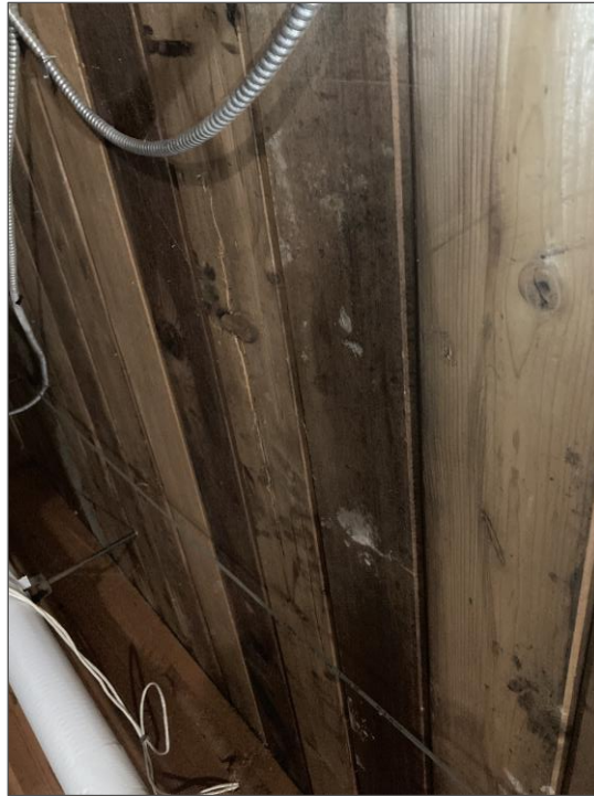
Photo 17 - Taches noires sur la structure en bois, vide sanitaire Nord
