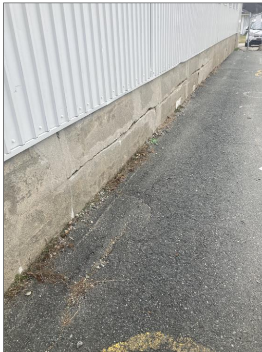
Photo 18 – Fissures dans la fondation, vis-à-vis la salle à dîner
