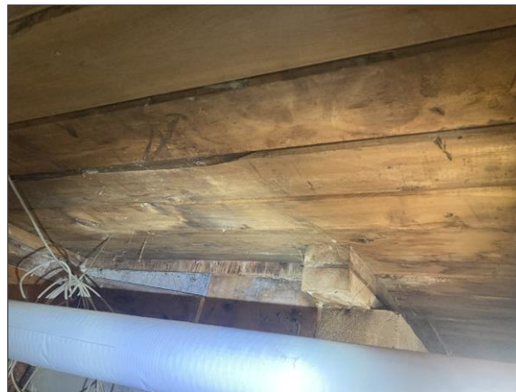
Photo 16 – Taches noires sur la structure en bois, vide sanitaire Nord
