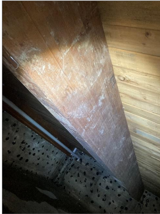
Photo 15 – Taches grisâtres sur des poutrelles, vide sanitaire Nord
