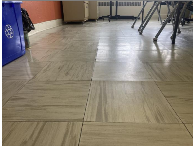
Photo 7 – Carreaux de plancher décollés, local 105
