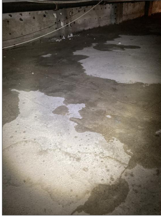
Photo 13 – Cerné d'eau sur la dalle en béton du plancher, vide sanitaire Nord
