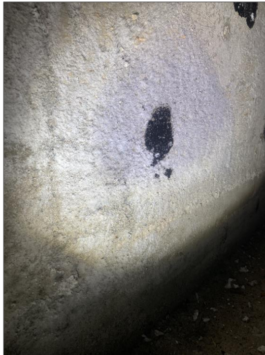
Photo 14 – Efflorescence sur le mur de béton, vide sanitaire Nord
