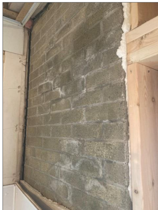
Photo 4 – Efflorescences sur mur de briques, salon des employés
