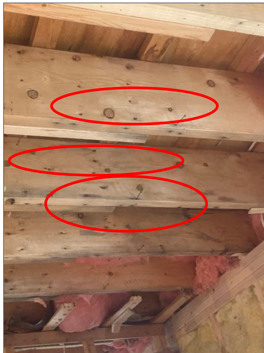
Photo 2 – Taches noires sur les poutrelles en bois, salon des employés
