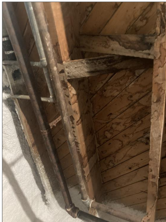
Photo 6 – Tache grisâtre et cerne d'eau sur le bois de la structure sous le local 107, salle mécanique et électrique
