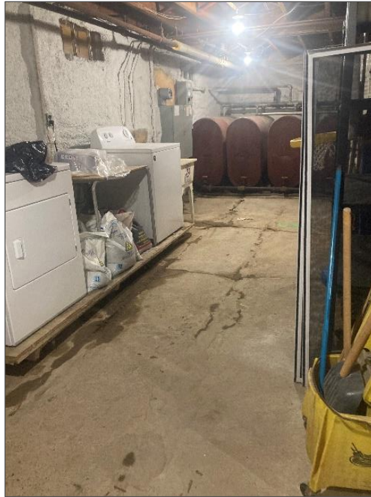
Photo 5 – Cernes d'eau à l'emplacement des fissures dans la dalle de béton du plancher, salle mécanique et électrique
