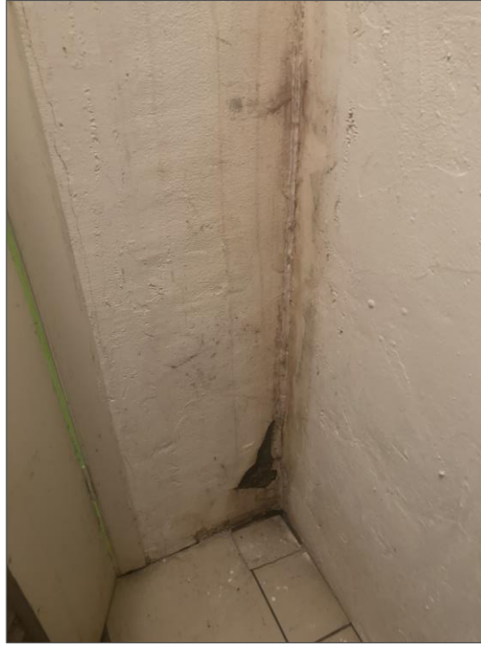
Photo 9 – Coulisse et taches brunâtres sur le mur Ouest adjacent à la salle à dîner, cage d'escalier Est
