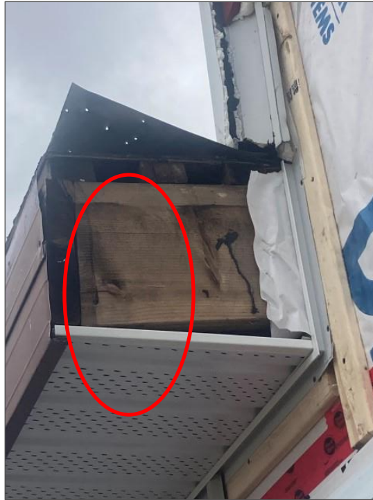
Photo 1 – Taches noires sur le bois de la toiture
